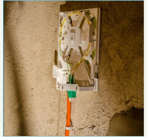
Anschluss im Keller/Technikraum
